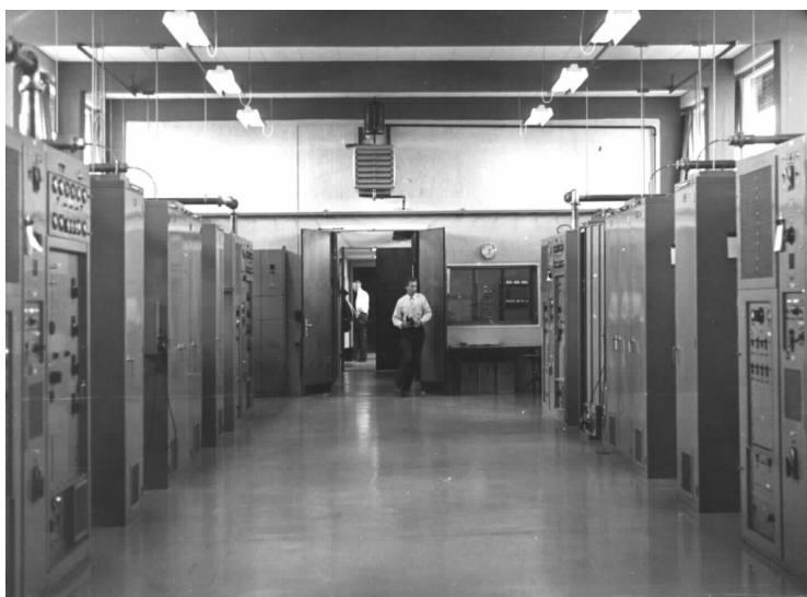
Den store sal med senderudstyret. Billedet er taget engang i tresserne, og ved at sammenligne med billedet længere fremme i artiklen, kan man se at både gulv og udstyr blev plejet godt. Dette billede er taget 20 år senere. (Foto Leif Petersen)
